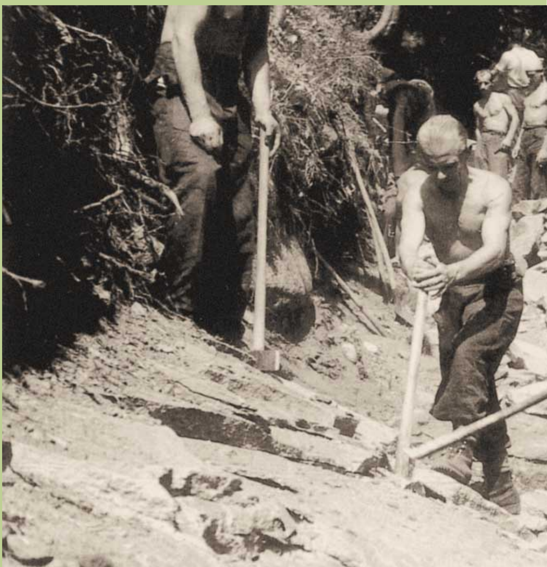
Militari polacchi impiegati a sistemare terreni a forte pendenza mediante costruzioni di ripiani con sostegni in muratura.
